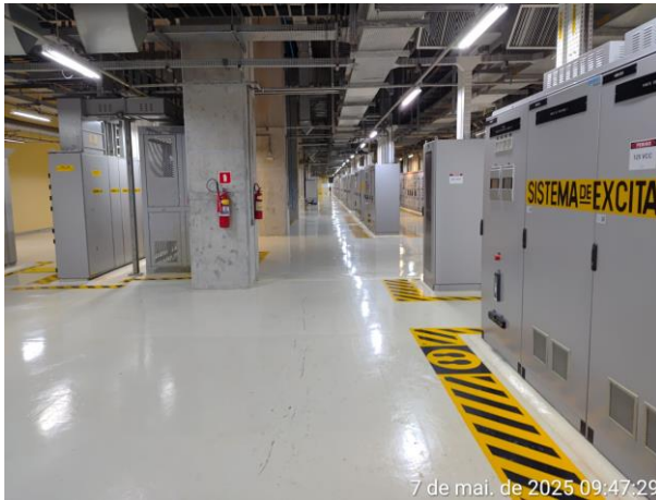
Foto 01: UHE Pimental. Galeria Elétrica. Vista interna da casa de força; notar a organização e limpeza das instalações e sinalização de segurança nos equipamentos.
