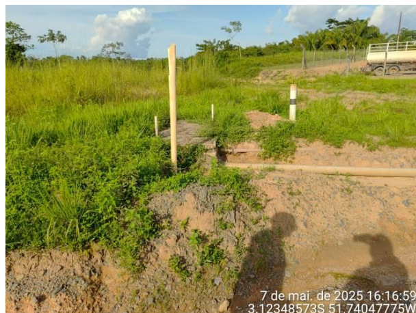
Foto 26: UHE Belo Monte – Canteiro da empresa Rocha Engenharia. Saneamento – caixa estanque para armazenamento de efluentes sanitários. Durante a visita foi verificado que a caixa estava com a tampa deslocada. Além disto, no período de 1 ano, não havia sido realizado nenhum esgotamento.
