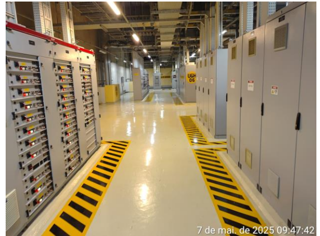
Foto 02: UHE Pimental. Galeria Elétrica. Vista interna da casa de força; notar a organização e limpeza das instalações e sinalização de segurança nos equipamentos.
