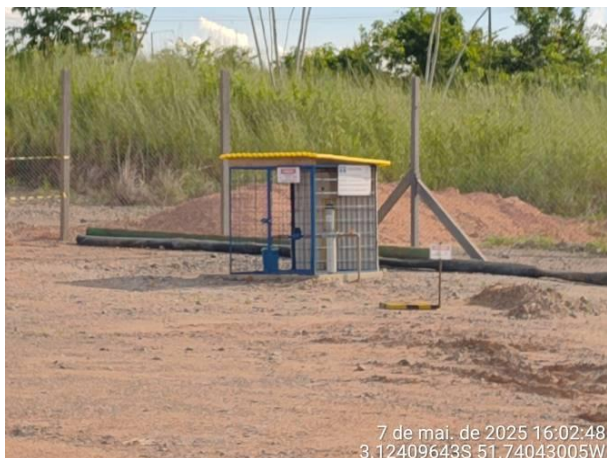
Foto 25: UHE Belo Monte – Canteiro da empresa Rocha Engenharia. Saneamento – poço tubular profundo. O poço está recém-construído, sendo aguardada a emissão da outorga de utilização da água subterrânea.
