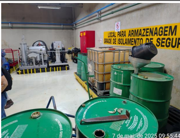
Foto 05: UHE Pimental. Galeria Mecânica – Sala de Produtos Químicos. Notar tambores, tanques e EBCs utilizados no armazenamento de óleo lubrificante utilizados na manutenção dos equipamentos de geração.
