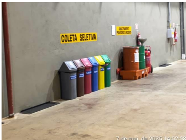
Foto 07: UHE Belo Monte – Galeria Mecânica Superior – Detalhe dos coletores de resíduos e tambores para armazenamento de resíduos perigosos e óleos usados.
