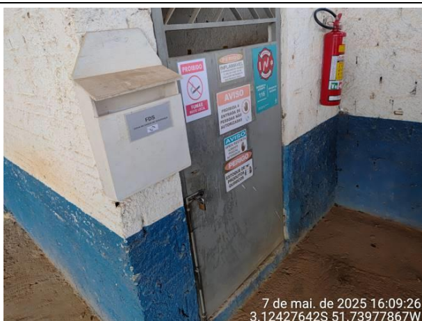
Foto 29: UHE Belo Monte – Canteiro da empresa Rocha Engenharia. Armário trancado de produto químicos (tintas, solventes e outros).
