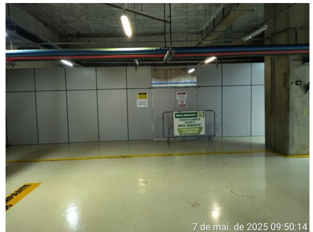
Foto 04: UHE Pimental. Galeria Mecânica. Vista externa da sala de produtos químicos.
