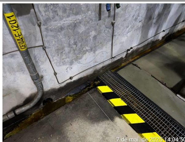
Foto 10: UHE Belo Monte – Galeria Mecânica Superior – Ligação da canaleta periférica com a drenagem interna da casa de força. Todas as águas coletadas no interior da casa de força são concentradas e tratadas nos sistemas de separação de água e óleo.
