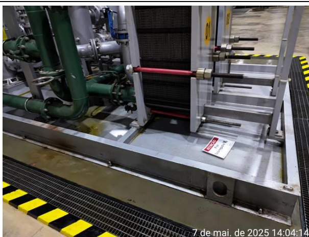
Foto 09: UHE Belo Monte – Galeria Mecânica Superior – Detalhe de equipamento montado em skid industrial com contenção de vazamento e instalado dentro do perímetro da canaleta de drenagem. Notar o pequeno vazamento de óleo no interior da contenção.
