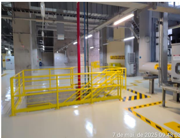
Foto 03: UHE Pimental. Galeria Mecânica. Vista interna da casa de força; notar a organização e limpeza das instalações e sinalização de segurança nos equipamentos.
